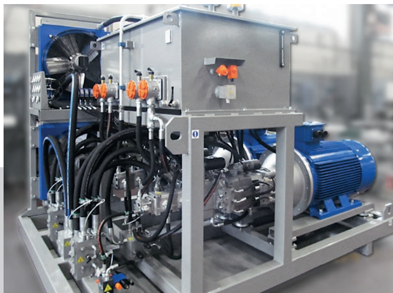
Applicazione in circuito chiuso (220 kW)
